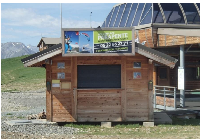
Enseigne dépassant du mur – non réglementaire
