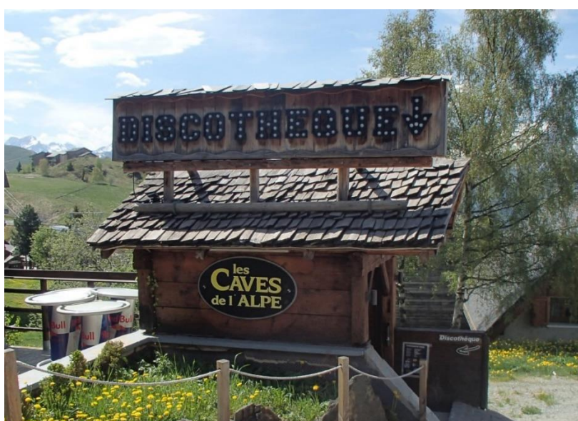
Une enseigne sur toiture (non conforme au RNP : panneau plein)
